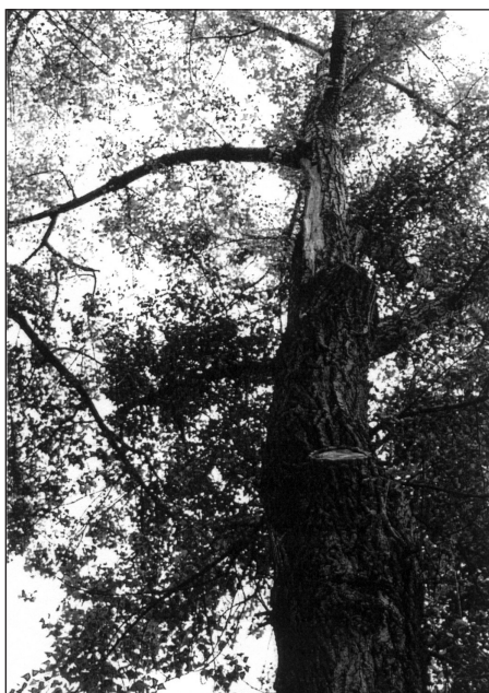
Pohľad do koruny mohutného topola: drevo je poškodené vysokým stupňom rozkladu v dôsledku výskytu bakteriôz, ktoré spôsobujú mokrú hnilobu. Kmeň je poškodený kvôli neodborne orezaným konárom. Nechali sa dlhé pahýle, ktoré nedokázali utvoriť hojivé pletivo, cez neošetřené rezné rany došlo k infikovaniu pletív hostiteľa baktériami a hubami. Strom má vysoko vyvetvený kmeň, s vidlicovitou korunou, hrozí rozlomenie konárov. Koruna sa nedá spevniť viazaním, lebo konáre sú poškodené vysokým stupňom poškodenia.
