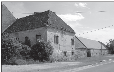
Komplex barokových budov Veľký Štít. V minulosti slúžil ako ženská polepšovňa, vojenské učilište, sklady. Teraz časť zachovaná, časť tesne pred zrútením.
