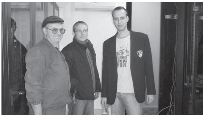
Serverovňa je srdcom celej metropolitnej siete, odkiaľ sa signál rozvádza optickým káblom.
